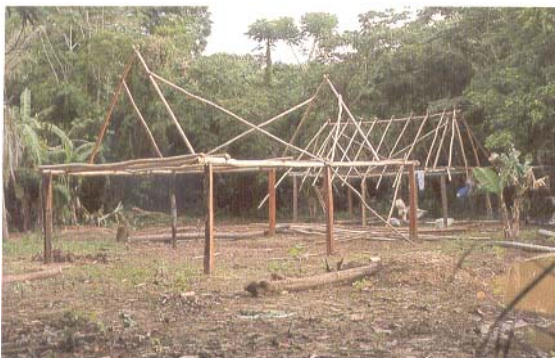
(96) Típicas estructuras de las actuales viviendas Yuracarés. Foto: Santa María de las Juntas (unión de los ríos Isiboro y Sécore), enero del 2003.
